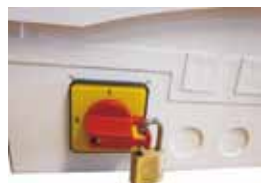
↑ Interruttore principale di manutenzione
