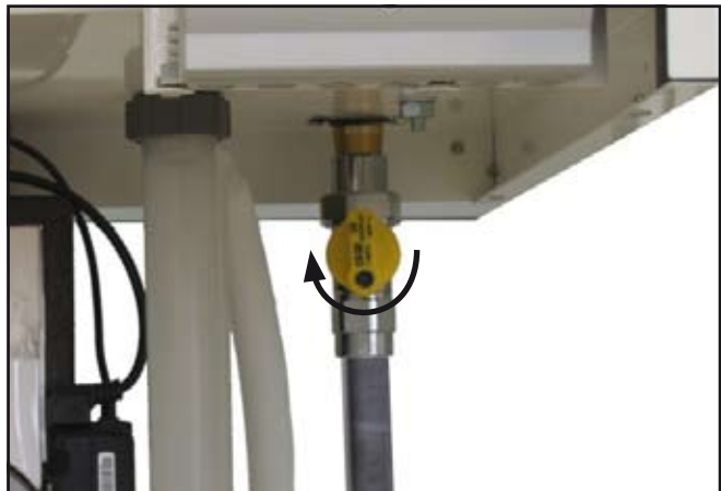
Figura: Conexión de gas Peligro por intoxicación y explosión por escape de gas
