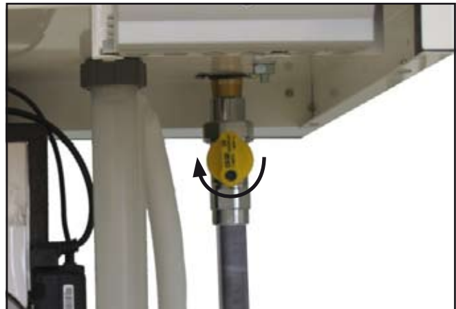
Figura: Attacco gas Pericolo di intossicazione e di esplosione per fuoriuscita di gas
