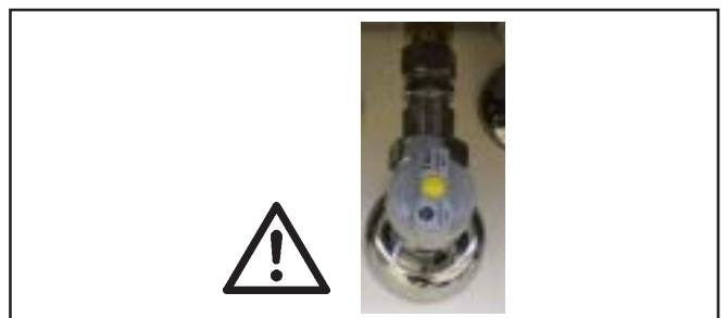
Figura: attacco gas Pericolo di asfissia e di esplosione per fuoriuscita di gas
